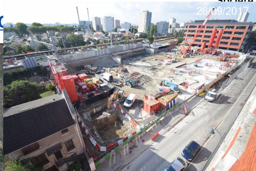
Travaux préparatoires à la réalisation des parois moulées et travaux SNCF sur voies RER D
