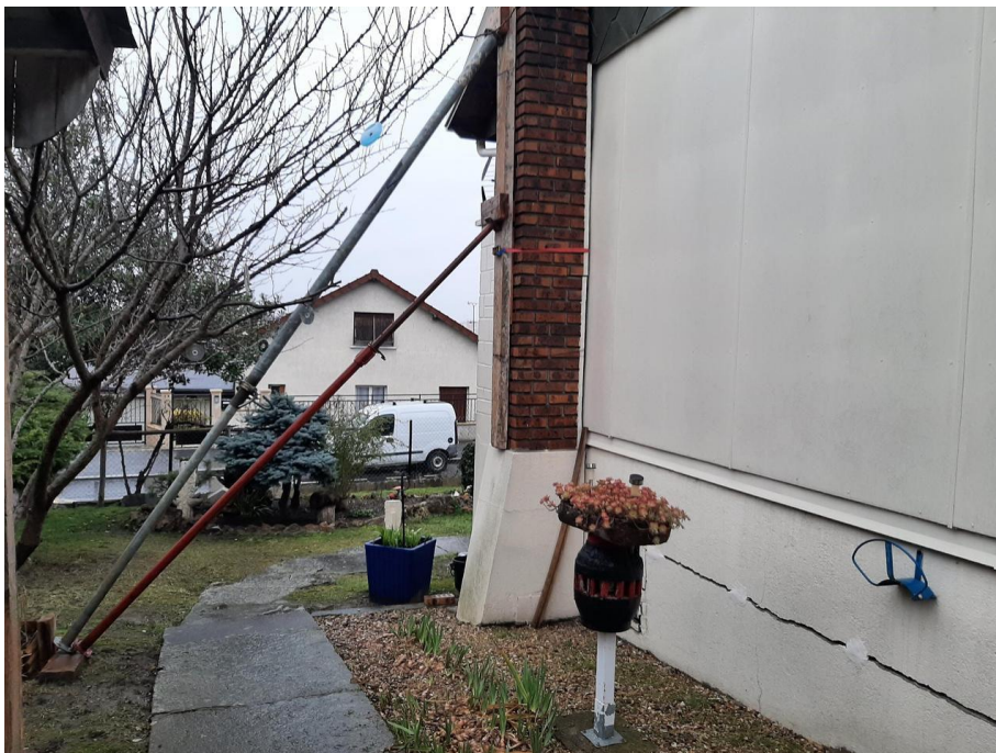
Exemple de désordre sur une habitation Cf. Le Parisien du 29 01 2021
